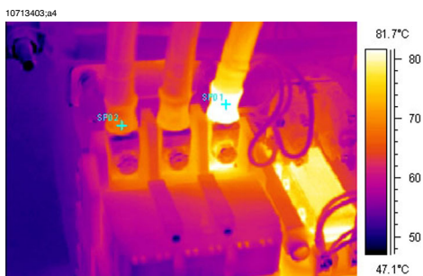
Obrázek 31.8 Infračervený obraz vnitřního elektrického zařízení (1).
